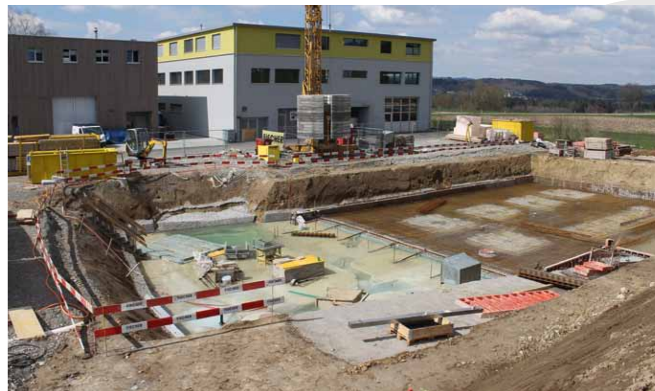
Die Bauarbeiten schreiten planmässig voran. Ende Jahr kann das neue Feuerwehrgebäude bezogen werden.
