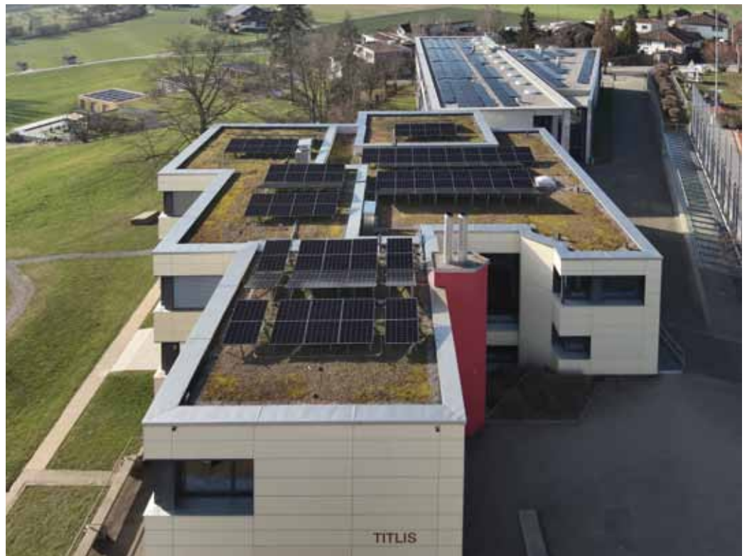
Die neuen Photovoltaikanlagen auf den Schulhäusern Titlis und Pilatus, realisiert im Sommer/Herbst 2025
